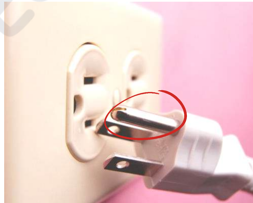
Toma de tierra
